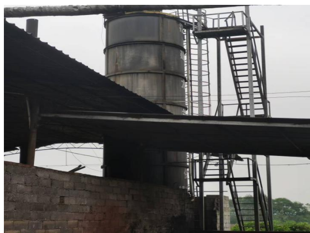
(锅炉) 静电除尘器
