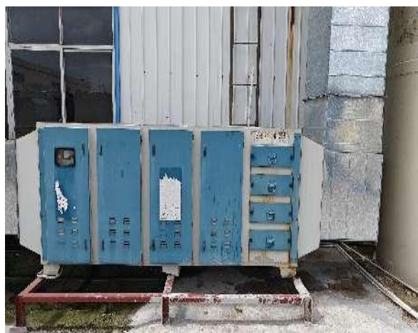
搅拌投料口废气喷淋塔+活性炭吸附装置
