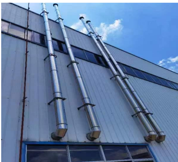
锅炉废气排气筒
