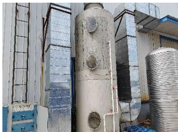
搅拌投料口废气喷淋塔+活性炭吸附装置
